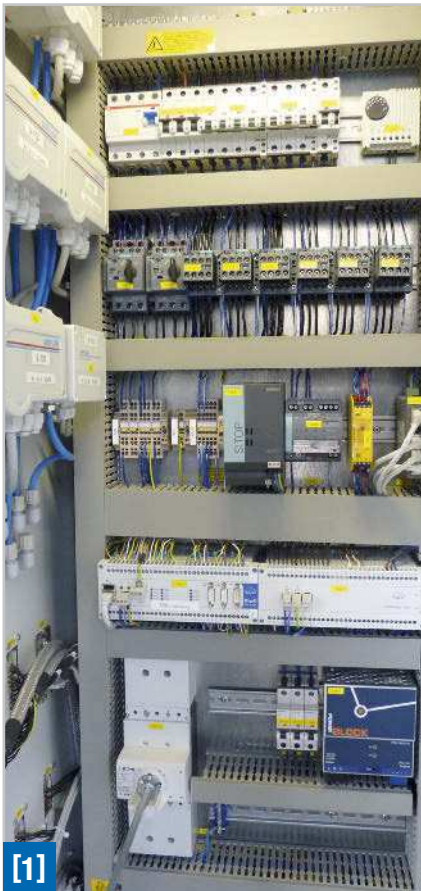
[1] Schaltschrank mit eingebautem Messtechnik-System und Messumformern sowie Relais zur Steuerung des Motors und der Drossel.
