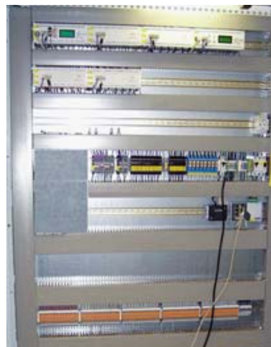
Reinraummonitoring-System auf Basis der Message-Geräte für etwa 200 Messstellen
