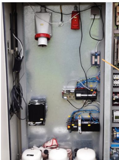
Einbausituation im Schaltschrank des Pumpwerks
